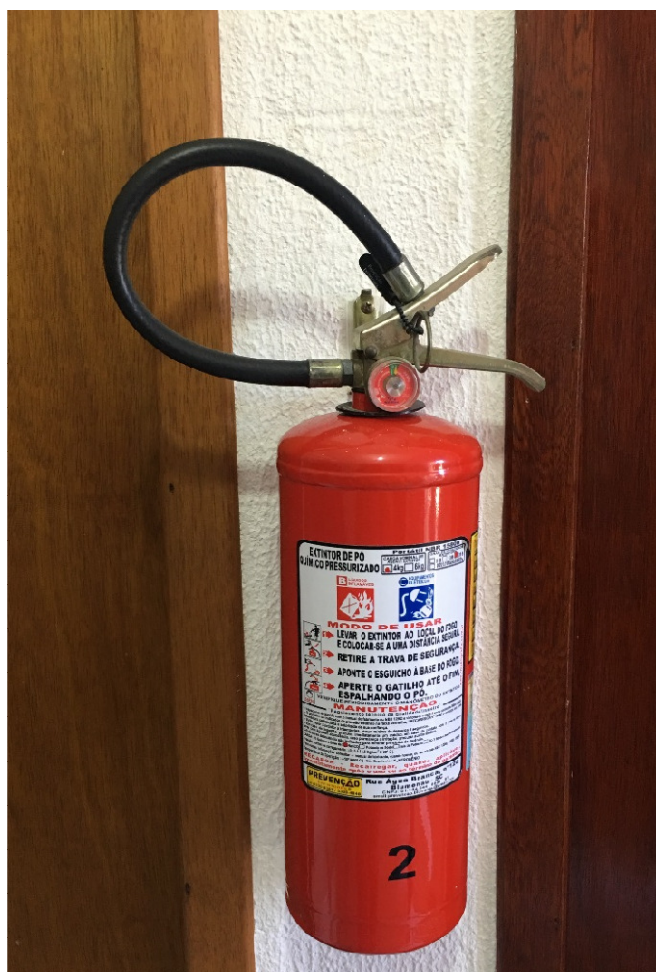
Foto 03 – Vista de extintor em um dos edifícios – Fonte CPL
