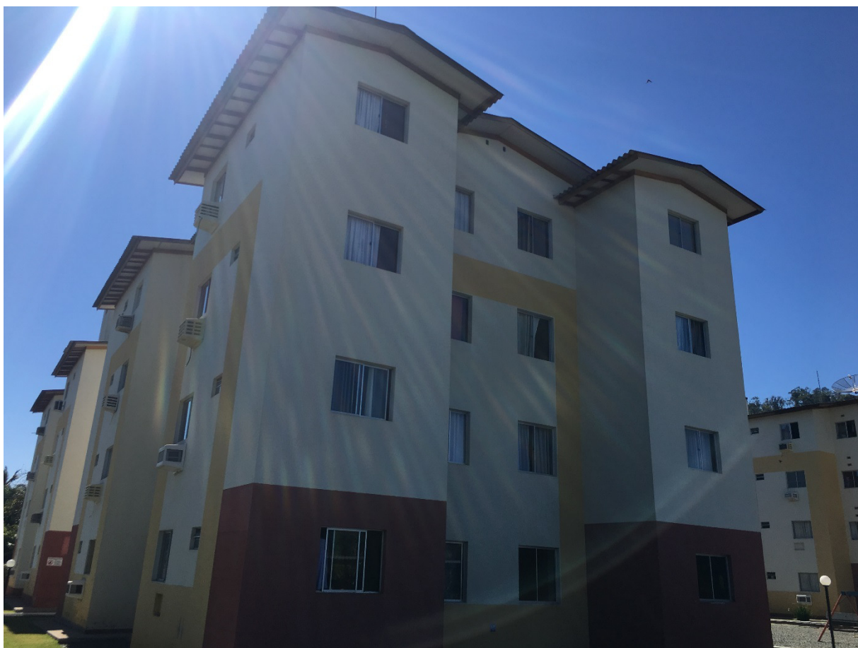
Foto 05 – Vista dos blocos do condomínio Bahia com pinturas velhas e coberturas sem calhas – Fonte CPL
