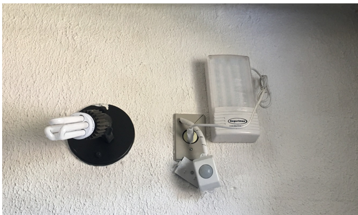
Foto 04 – Vista de iluminação de emergência em um dos edifícios – Fonte CPL
