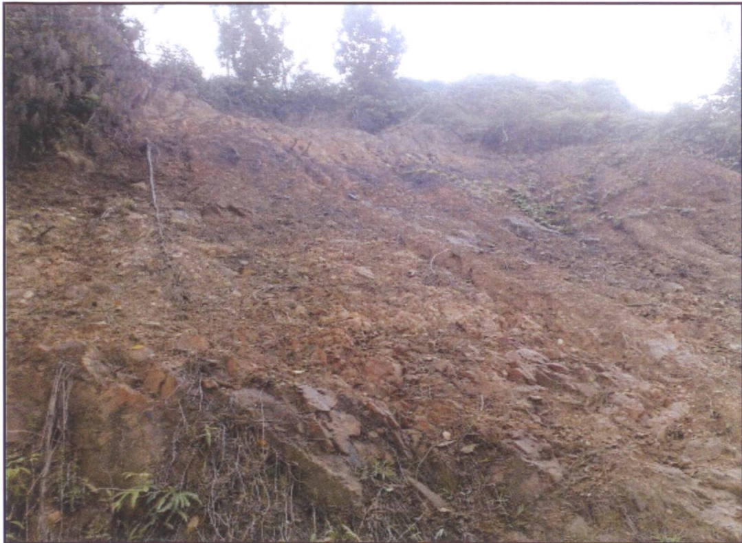
Foto 2 - Seção transversal Y do talude posterior ao deslizamento
