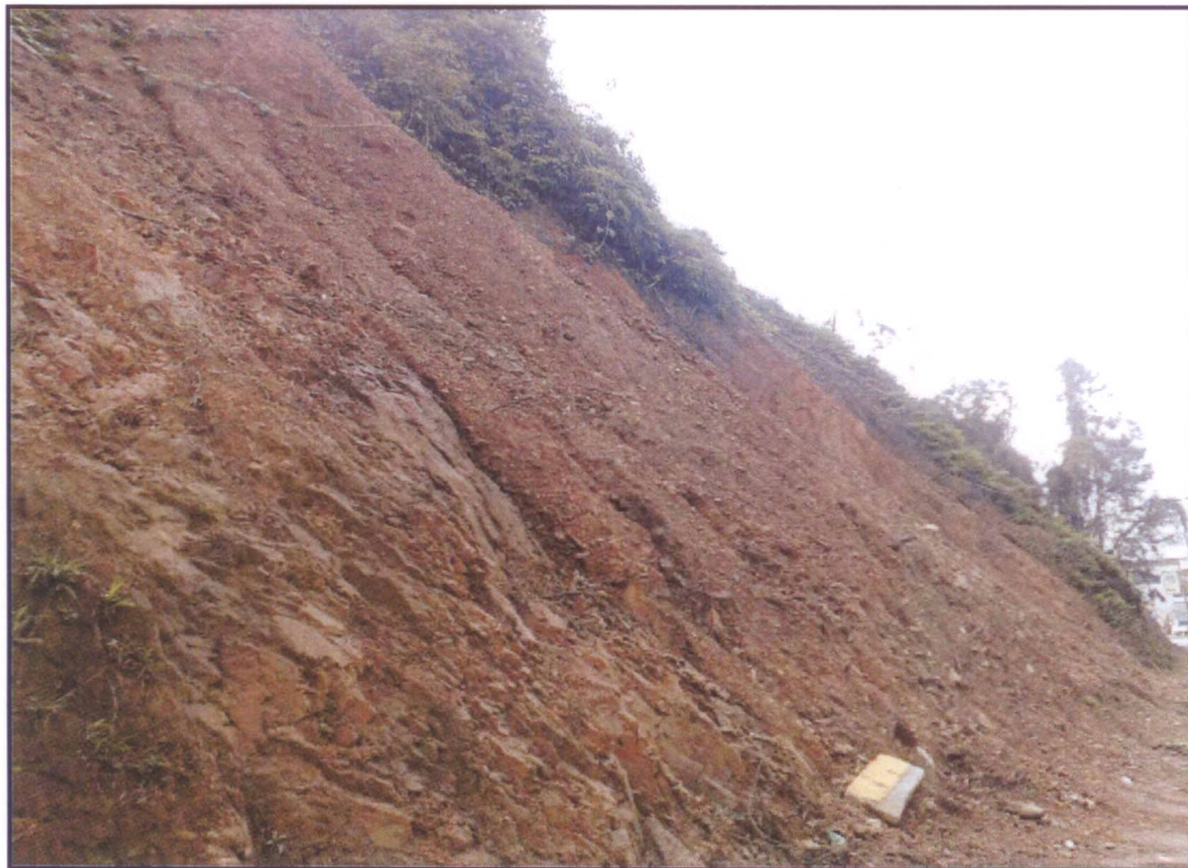
Foto 3 - Seção transversal X do talude posterior ao deslizamento
