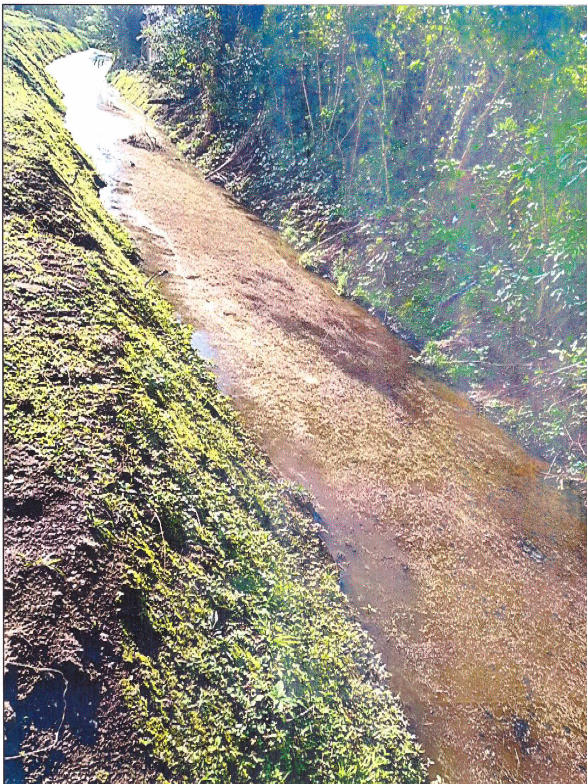
Figura 3 - Percurso da água servida expondo não só a largura do trecho de escoamento, mas também o prolongamento das camadas graxosas ao longo de todo o trecho investigado.
